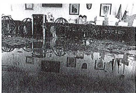
Lanske avgustovske poplave so škodo povzročile tudi v stavbi sedeža Občine Medvode. Obnovili bodo celotno pritličje, v katerem je voda zalila tudi sejno sobo (na fotografiji). / Foto: Tina Doki
