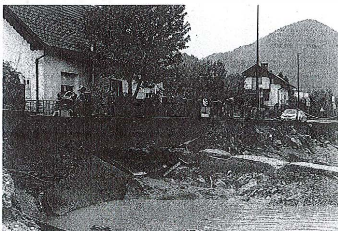
Narasla Sora je pri jezu v Goričanah izpodjedla cesto z avtobusnim postajališčem. Promet poteka izmenično enosmerno. Projektanti so že pripravili projekt za sanacijo, ki je načrtovana še v letu 2023. / Foto Peter Košenina
